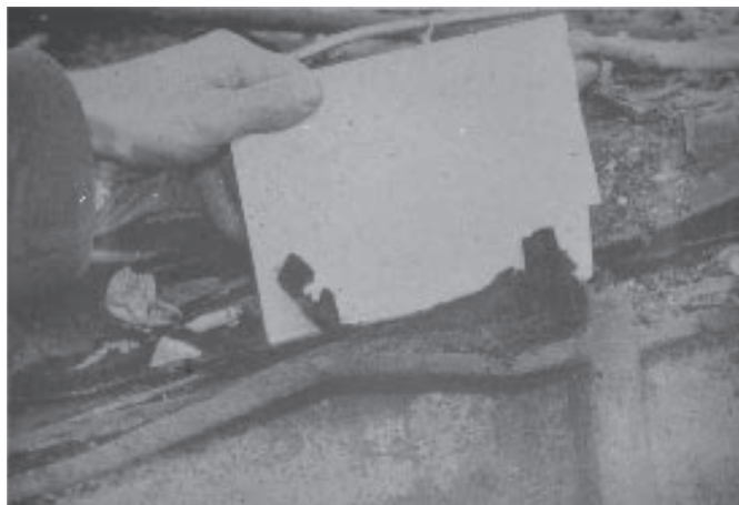
Obr. 15 Ukázka koroze skříně prvního vozu expresu Pannonia v místě uchycení k podvozku.
