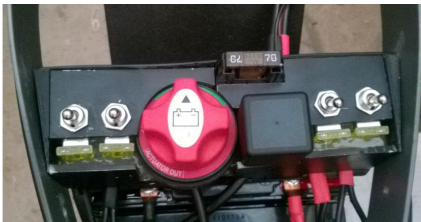
Obrázek 4: Přepínací panel (foto autor)
