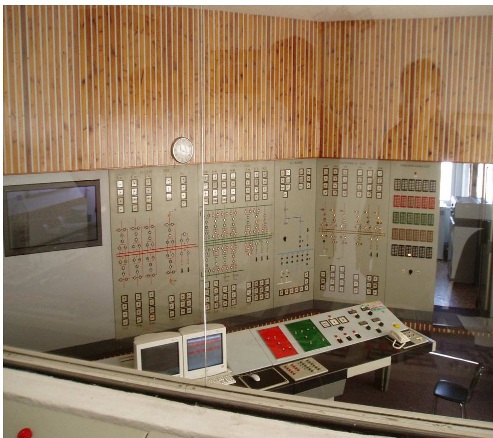
Obrázek č. 5: Pohled v velínu na pracoviště obsluh
