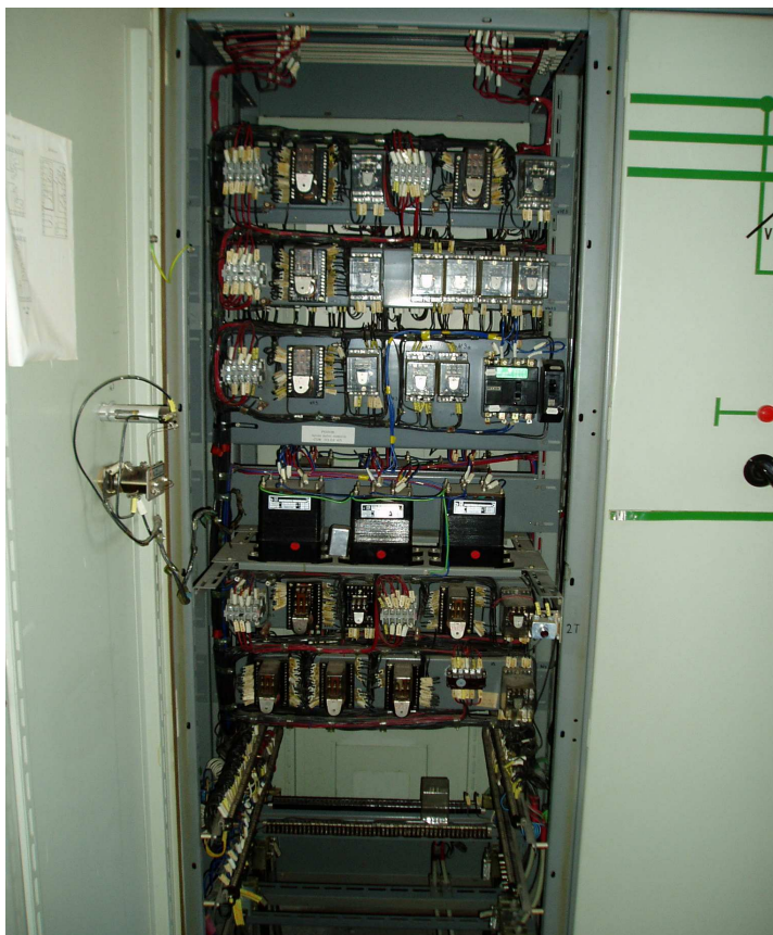
Obrázek č.8: Vybavení kobky 110kV
