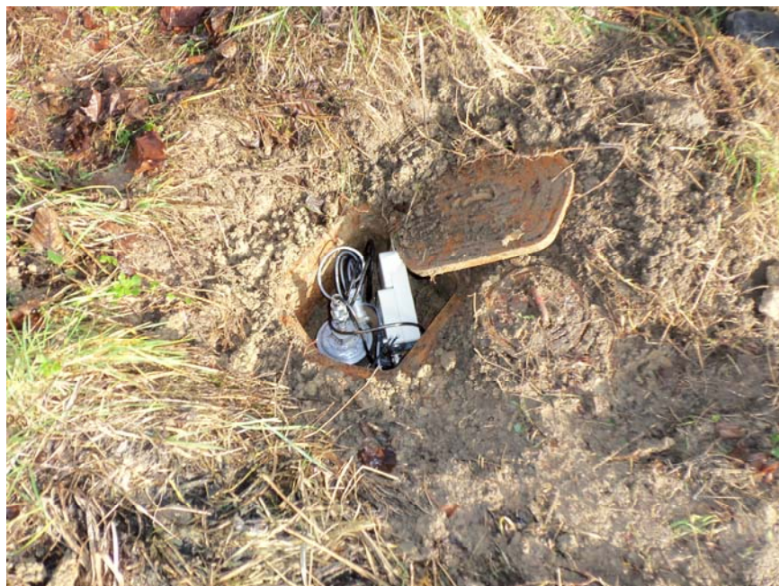
Obr. 4.8 Měření tlaků ve vodovodní síti – měřicí místo č.1 – ukázka měřicího čidla COSMOS CDL 2U osazeného v podzemním hydrantu
