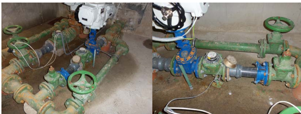
Obr. 4.5 Střelná - měřicí armaturní šachta na přítoku do obce – měření průtoků, uzávěry
