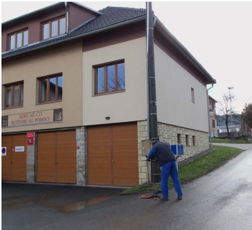
Obr. 4.7 Měření tlaků ve vodovodní síti – měřicí místo č.3 – ukázka osazování měřicího čidla
