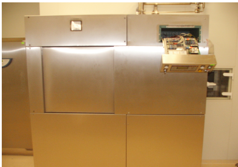
Obr. C.1: Sterilizátor s vysunutým rozvaděčem
