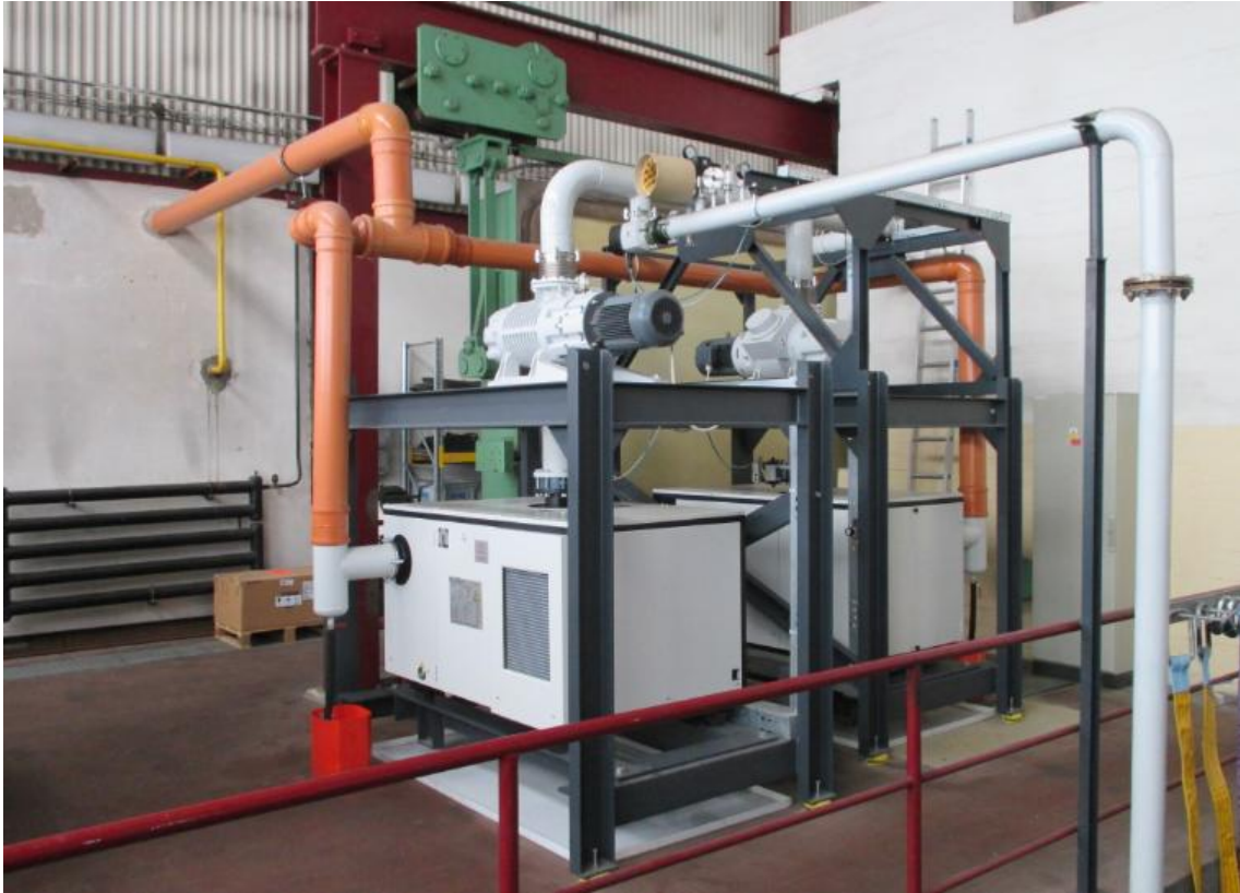
Obrázek 19-Systém vakuových vývěv [6]
