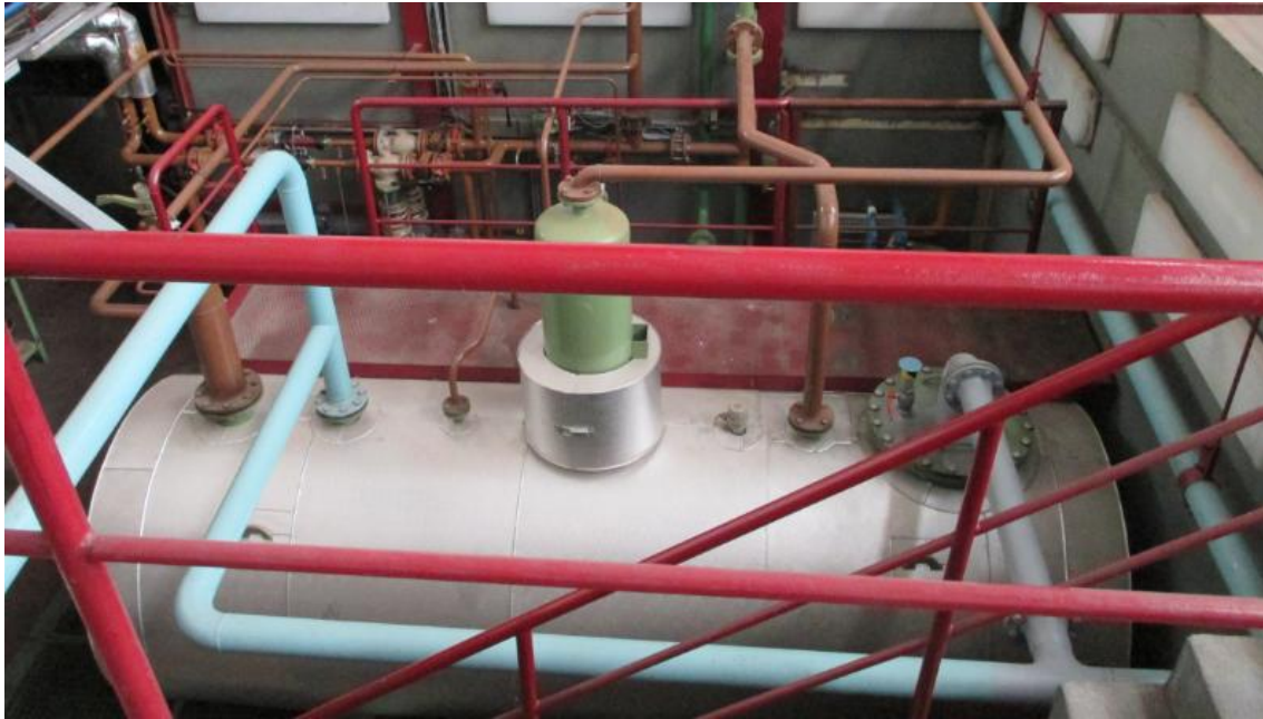
Obrázek 20-Pohled na nádrž vakuového olejového systému [6]
