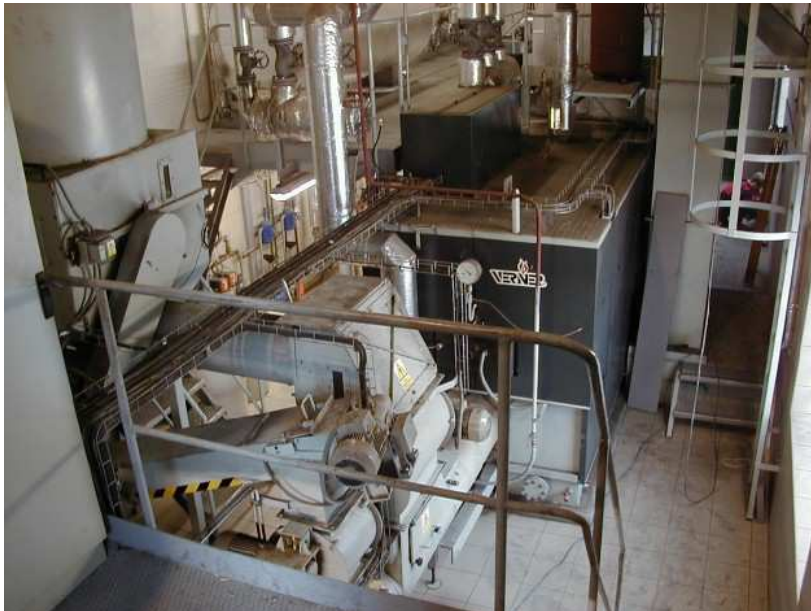
Obr. 6 Kotelna firmy Fitmin a.s. čerstvě po instalaci kotle v roce 2004. Zatím bez parního domu [11]
