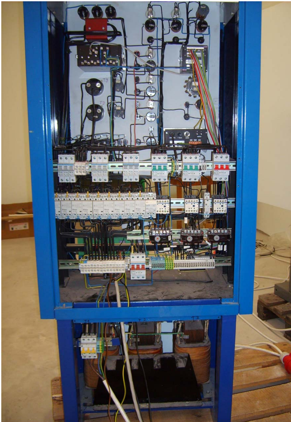
Obr.11.2: Pohled do elektrického ovládacího panelu
