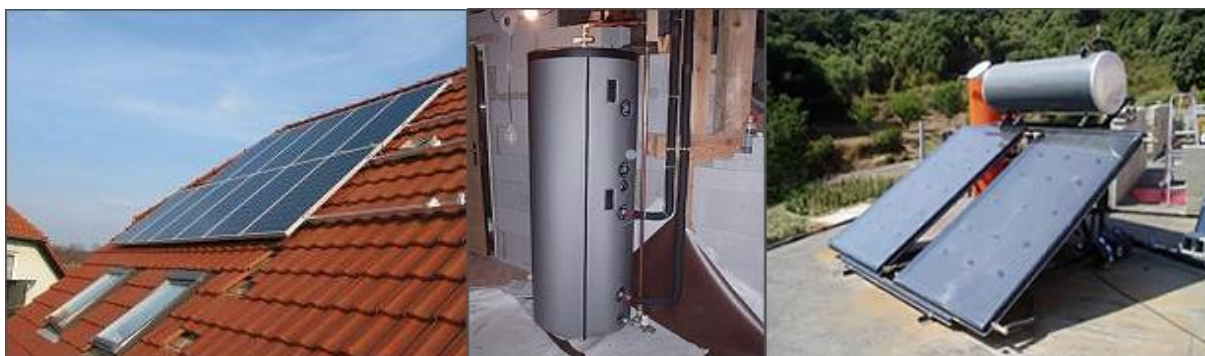
Obr. 1.7 Ukážky aktívneho využitia slnečného žiarenia (1) Fotovoltaické panely na streche (2) Zásobník teplej vody (3) Jednookruhový solárny systém [6]
