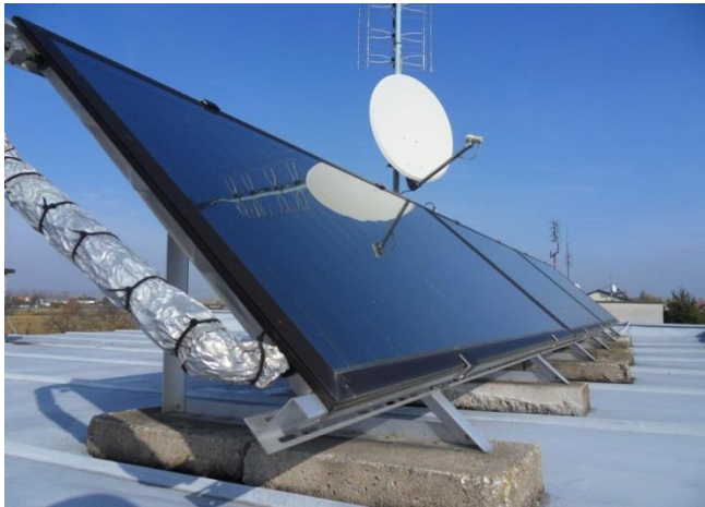
Obr. 2.4 Fototermické kolektory na streche rodinného domu
