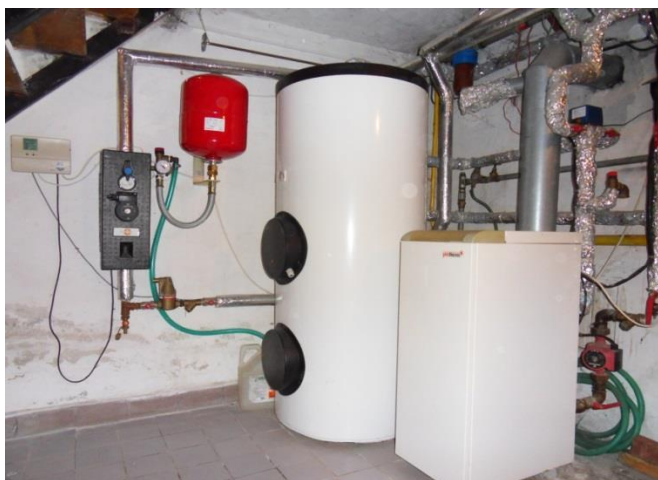
Obr. 2.6 Pohľad na vybavenie technickej miestnosti rodinného domu (vpravo plynový kotol)
