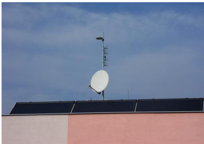
Obr. 2.5 Pohľad na fototermické kolektory z ulice pred rodinným domom
