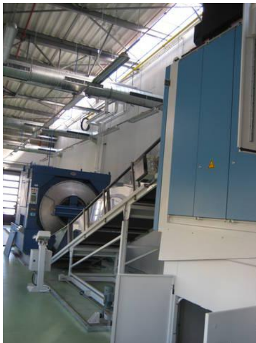
Obrázek: Vnitřní prostory prádelny
