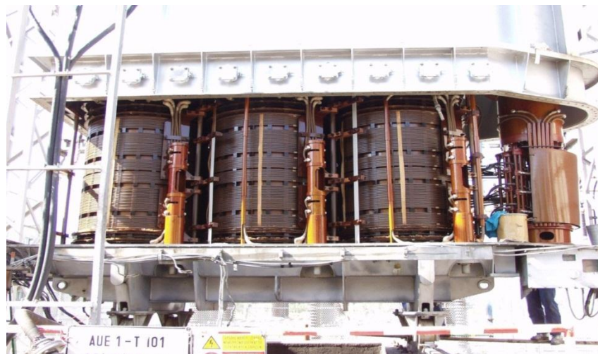
Obrázek 10. Transformátor (Zdroj: Energopoint.cz, 2015)
