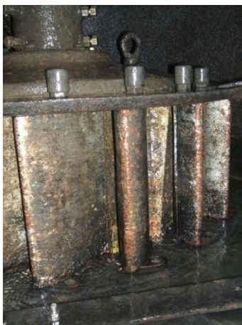
Obr. 11 Pohled na zavičkované svorníky, rozváděcí lopatky, bronzová tahélka
