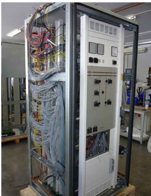
Obr. 8: Specifický rozvaděč NN – výrobek společnosti Logaritma a.s. pro ABB (Dokumentace společnosti)
