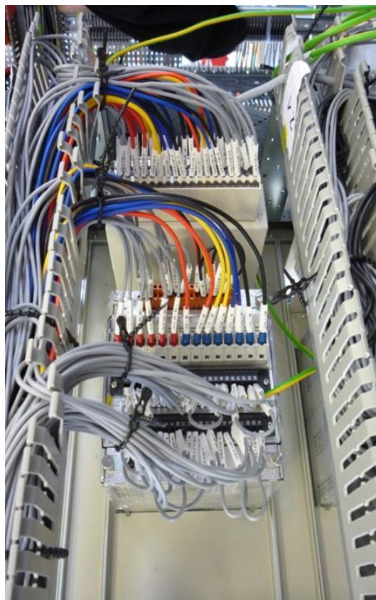
Obr. 9: Svorkovnice rozvaděče NN (Dokumentace společnosti)
