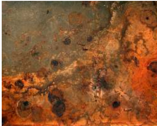
Obr.3: Korózia na povrchu kovového materiálu
