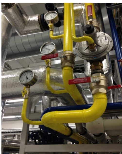
Obr. 11: Manometry pro měření přetlaku v plynovém potrubí
