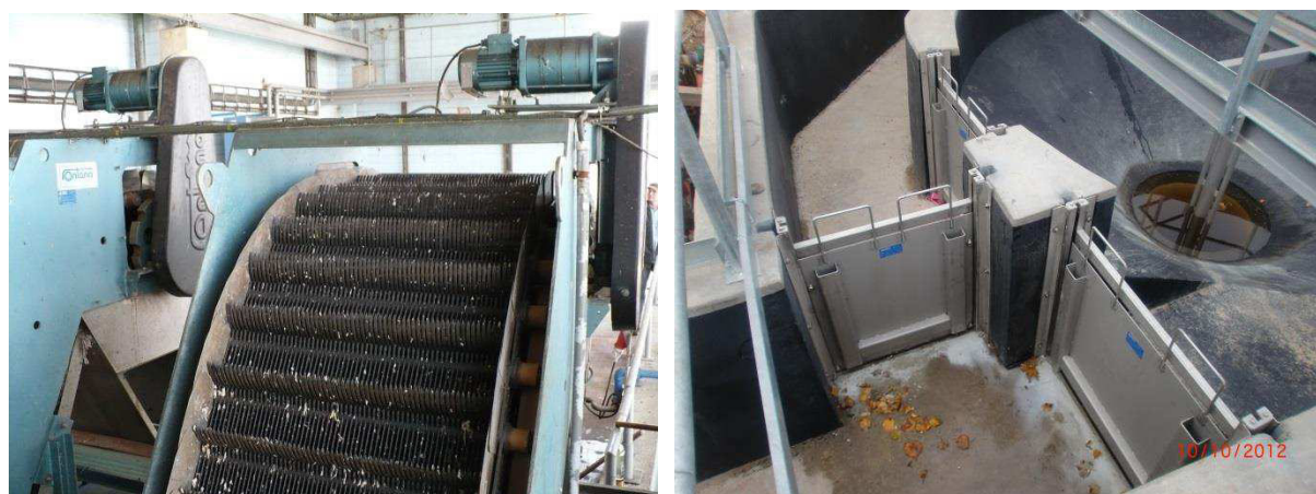
Obr. 11 Strojně stírané česle s průlinami 6mm (vlevo) a lapák písku (vpravo) po rekonstrukci
