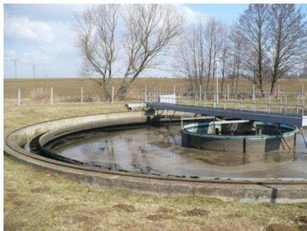
Obr. 14 Dosazovací nádrž před rekonstrukcí
