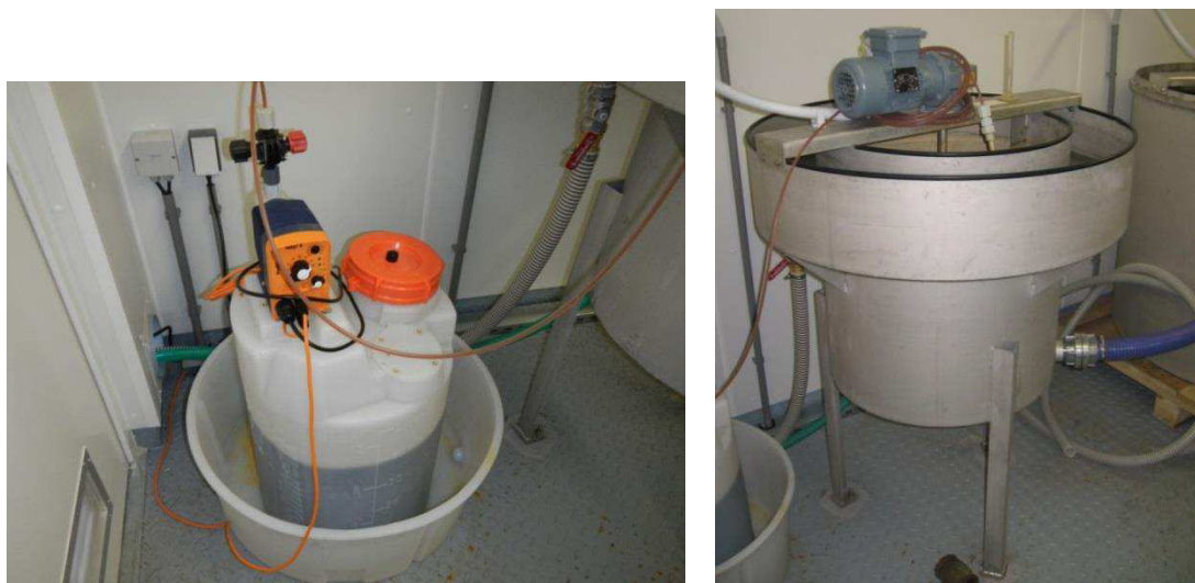
Obr. 18 Zásobník s dávkovacím čerpadlem roztoku síranu železitého a nádoba rychlomísení s nátokovým prstencem
