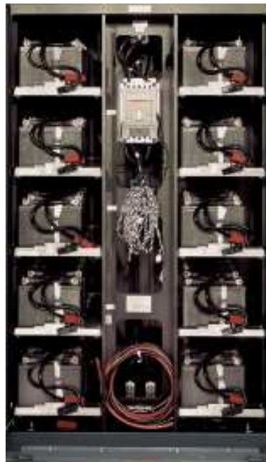
Obr. 13 : Bateriová skříň k UPS
