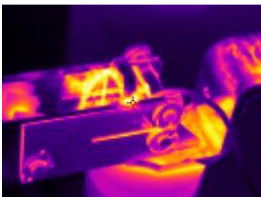
Obrázek 38 - Termo snímek pevného kontaktu odpojovače
