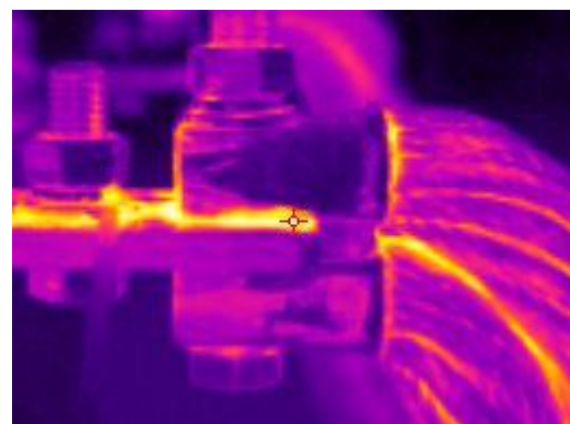
Obrázek 39 - Termo snímek přechodu vstupní praporec – vstupní kabel
