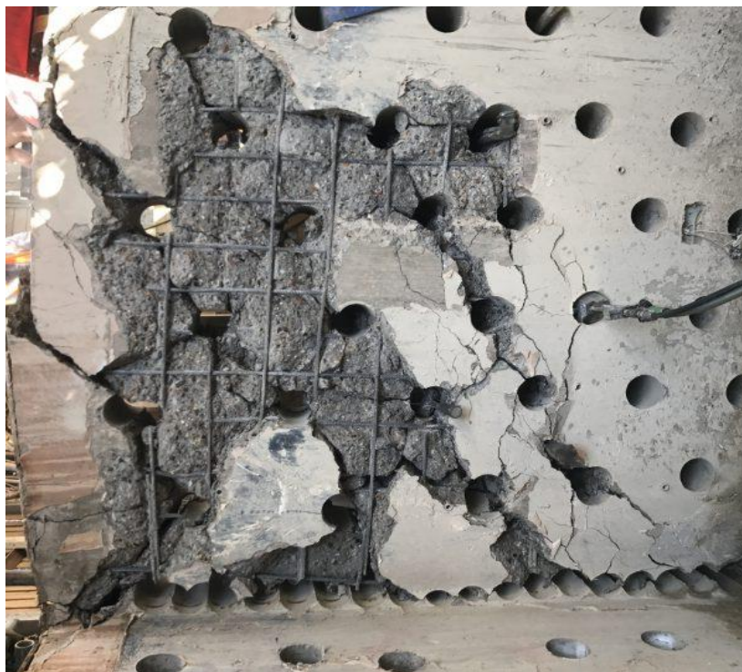
Obr. 2 Tlakové narušení betonové zdi
