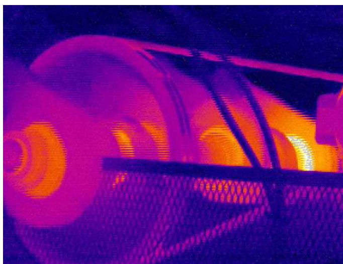
Obr. 2.1 Termogram přehřívajících se ložisek. [13]
