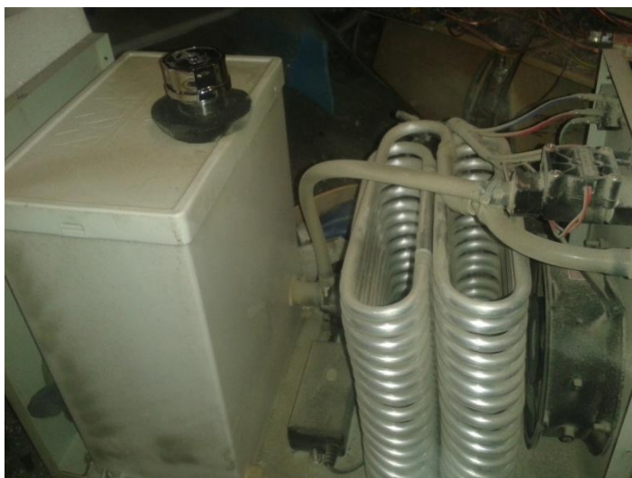
Obr. 3.2 Znečištěný vnitřní prostor přístroje [31].
