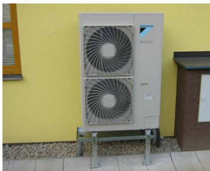
Obrázek 11: Venkovní jednotka TČ vzduch-voda umístěná u zdi domu[26]
