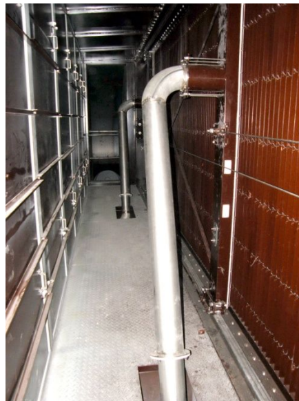
Obr. 21 - vnitřní uspořádání filtru (bezprašná komora), v pozadí viditelný rotor hlavního tahového ventilátoru
