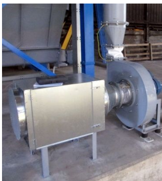
Obr. 24 - ventilátor regenerace filtru
