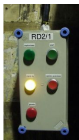
Obr. 37 - ovládací panel pracoviště vypalování kelímků
