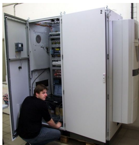
Obr. 42 - rozvaděč RD1 osazen klimatizačními jednotkami na zkouškách v ESB Brno
