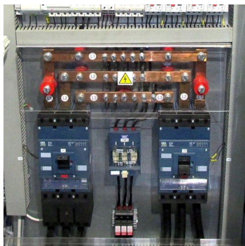
Obr. 40 - výkonové jističe (deony) "F1" a "F2" s přípojnicovým systémem v rozvaděči RD1
