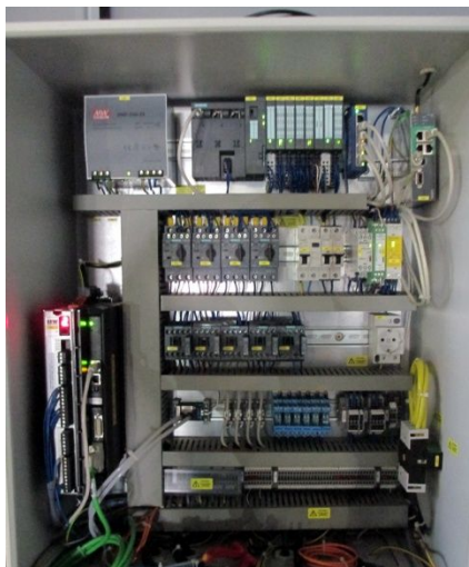
Obr. 23 - rozvaděč řízení regenerace
