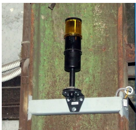
Obr. 72 - stojan akustické a světelné signalizace
