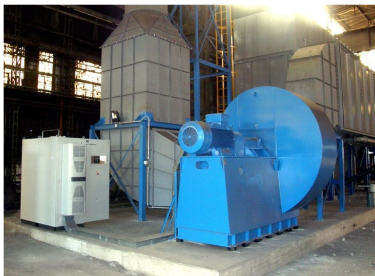
Obr. 4 - pohled na filtrační jednotku s hlavním tahovým ventilátorem a hlavním rozvaděčem řízení RD1
