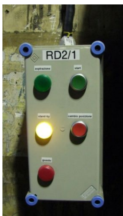
Obr. 62 - ovládací panel pracoviště vypalování kelímků
