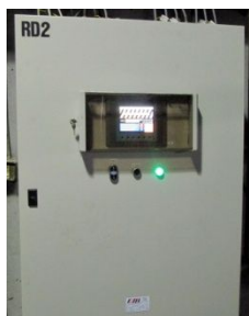
Obr. 35 - rozvaděč RD2 s operátorským panelem pro pec 8t
