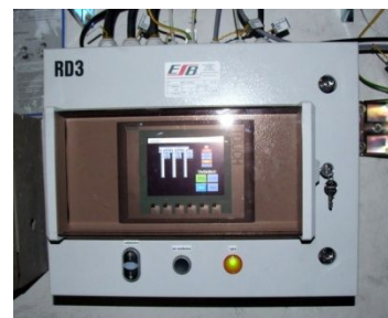
Obr. 36 - rozvaděč RD3 s operátorským panelem pro pec 12t
