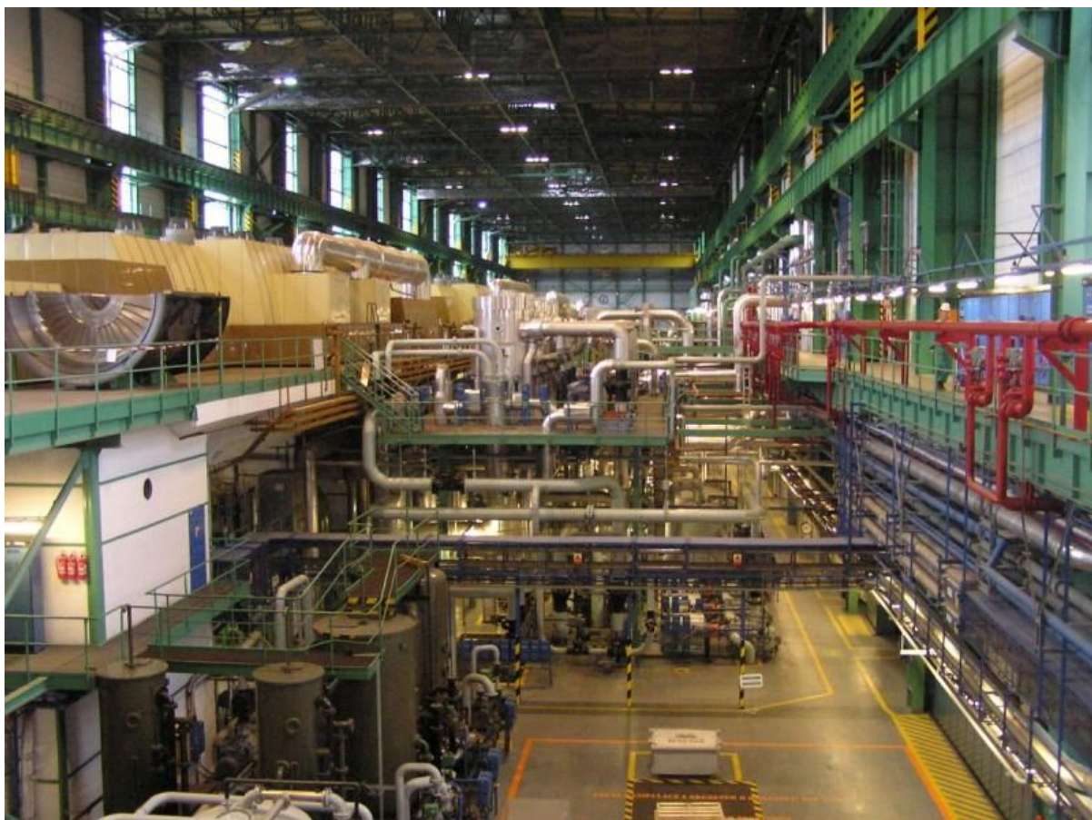
Obrázek 11 Strojovna jaderné elektrárny Dukovany [14]
