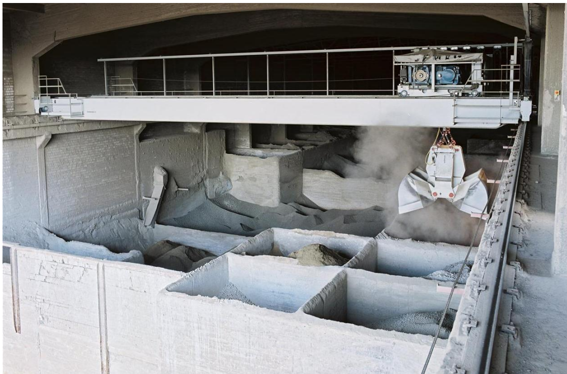
Obr. 11 Ukázka automatizovaného portálového jeřábu v cementárně [28]
