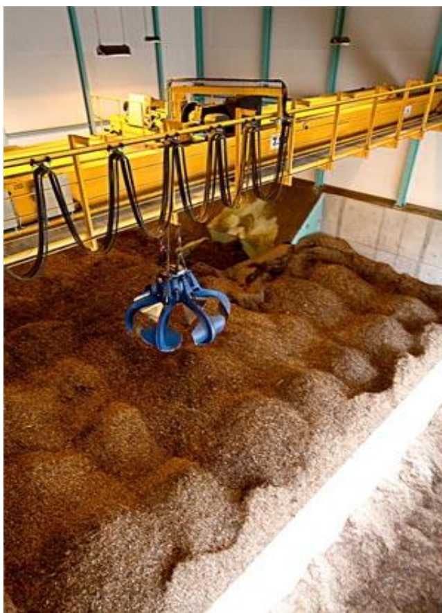
Obr. 19 Automatizovaný jeřáb WTE od společnosti Konecranes [39]
