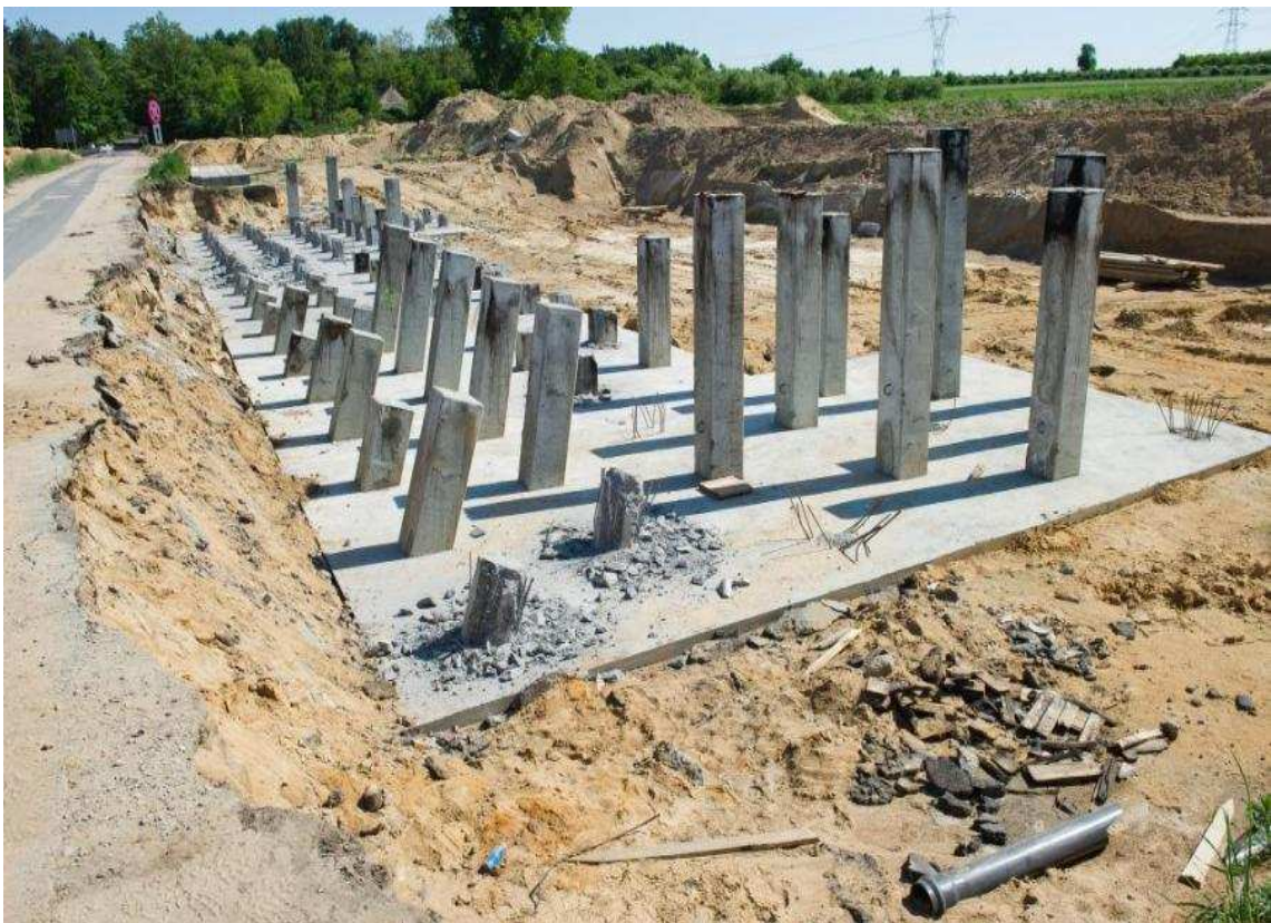
Obr. 3.8: Ražené železobetonové piloty (u některých pilot je vidět poškození hlavy důsledkem beranění) [12]
