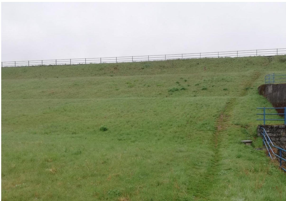
Obrázek 11: Porušení osetí na vzdušném svahu
