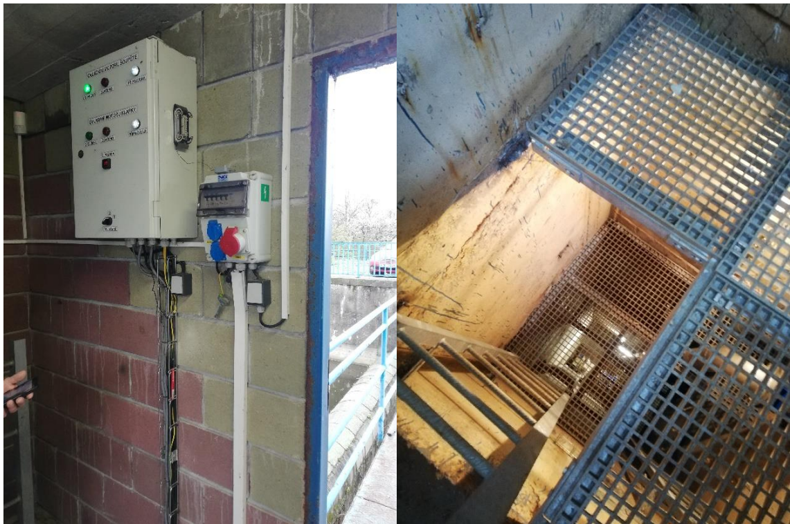
Obrázek 6: Ovládání spodních výpustí
