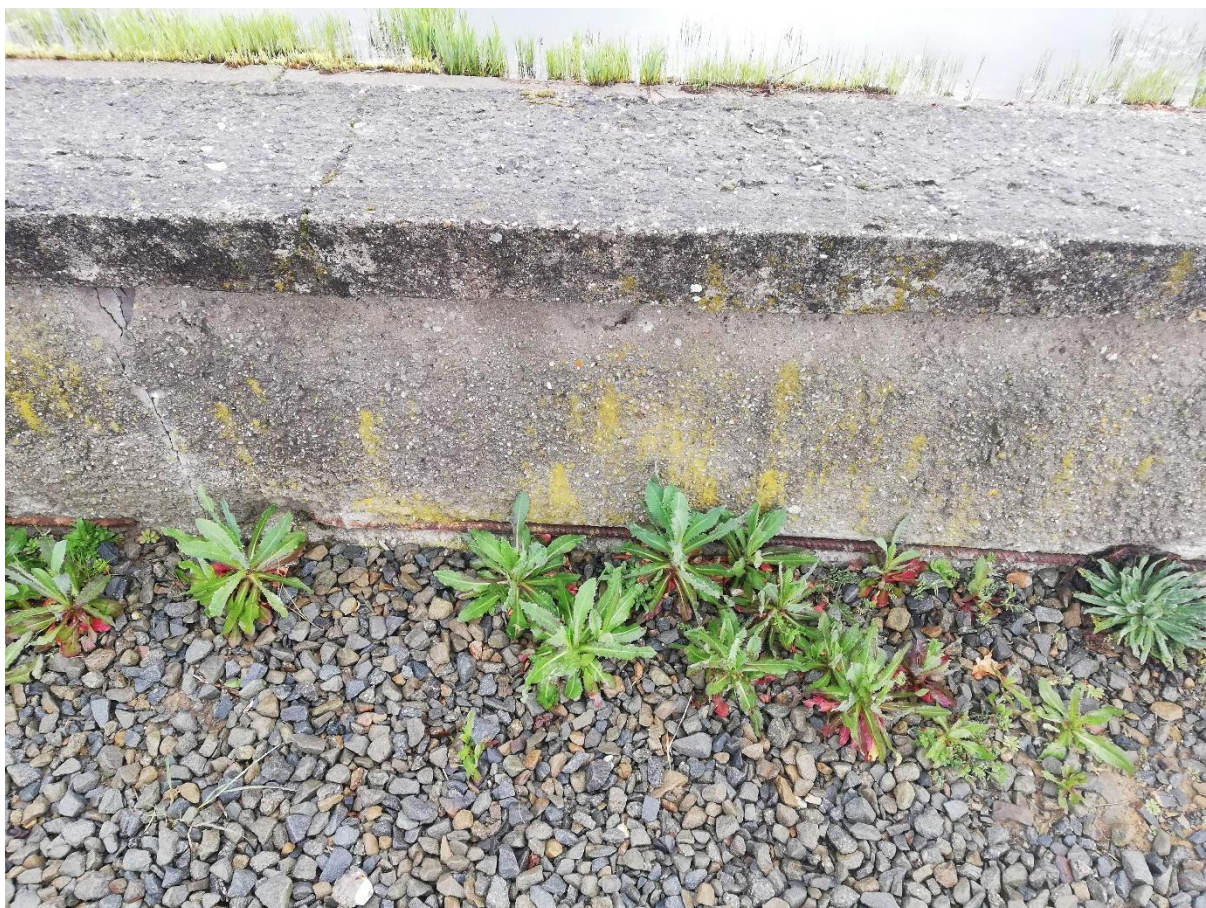
Obrázek 10: Odhalená výztuž ve spodní části vlnolamu
