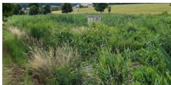
Obr. 13 – pohled na filtrační lože
