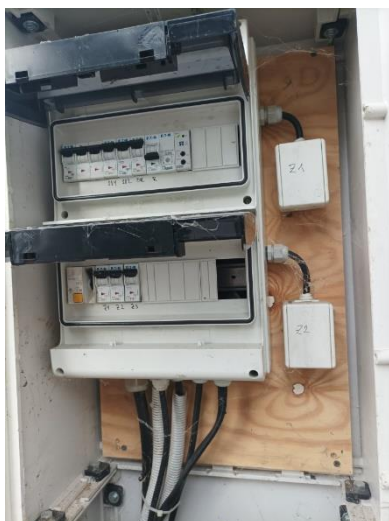
Obrázek 2-8 Skříň s rozváděčem pro jištění osvětlovací soustavy
