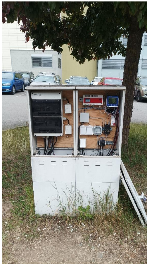
Obrázek 4-1 Rozváděč VO po realizaci zařízení pro dálkové řízení
