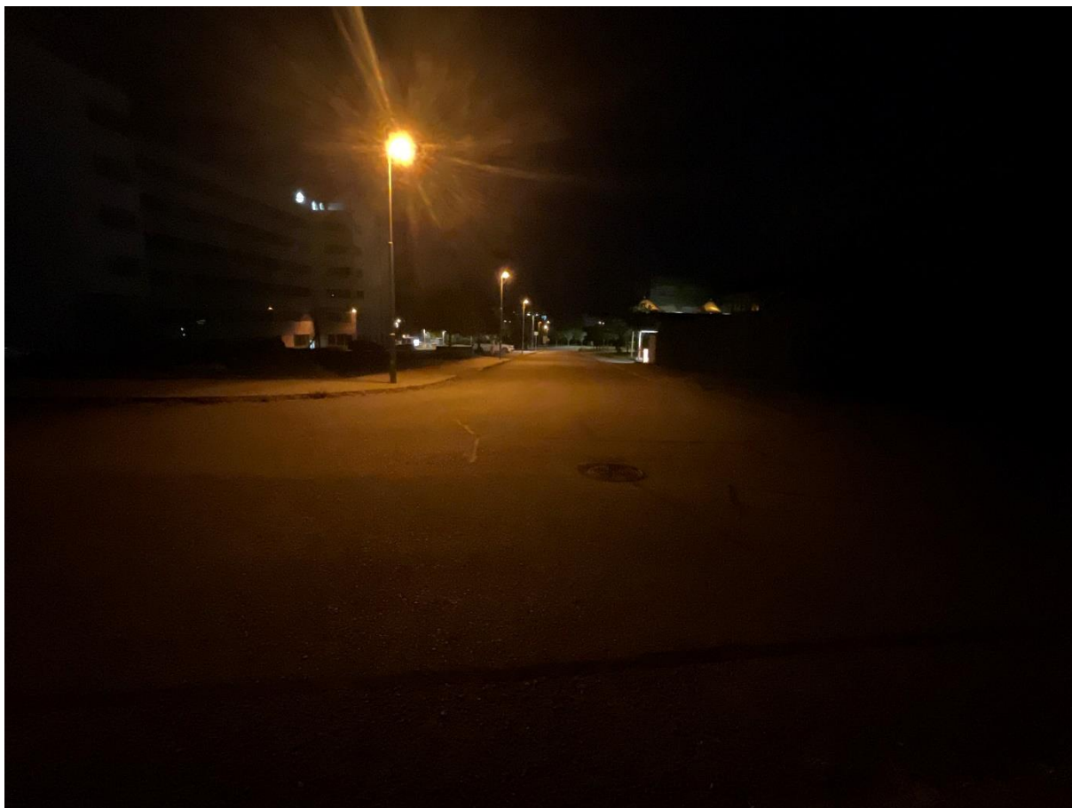
Obrázek 4-4 Osvětlení po realizaci dálkového ovládání - 1800 K
