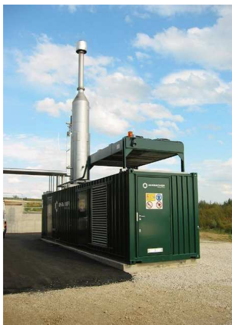
Obr.2-2 Kontejnerové provedení kogenerační jednotky [15]
