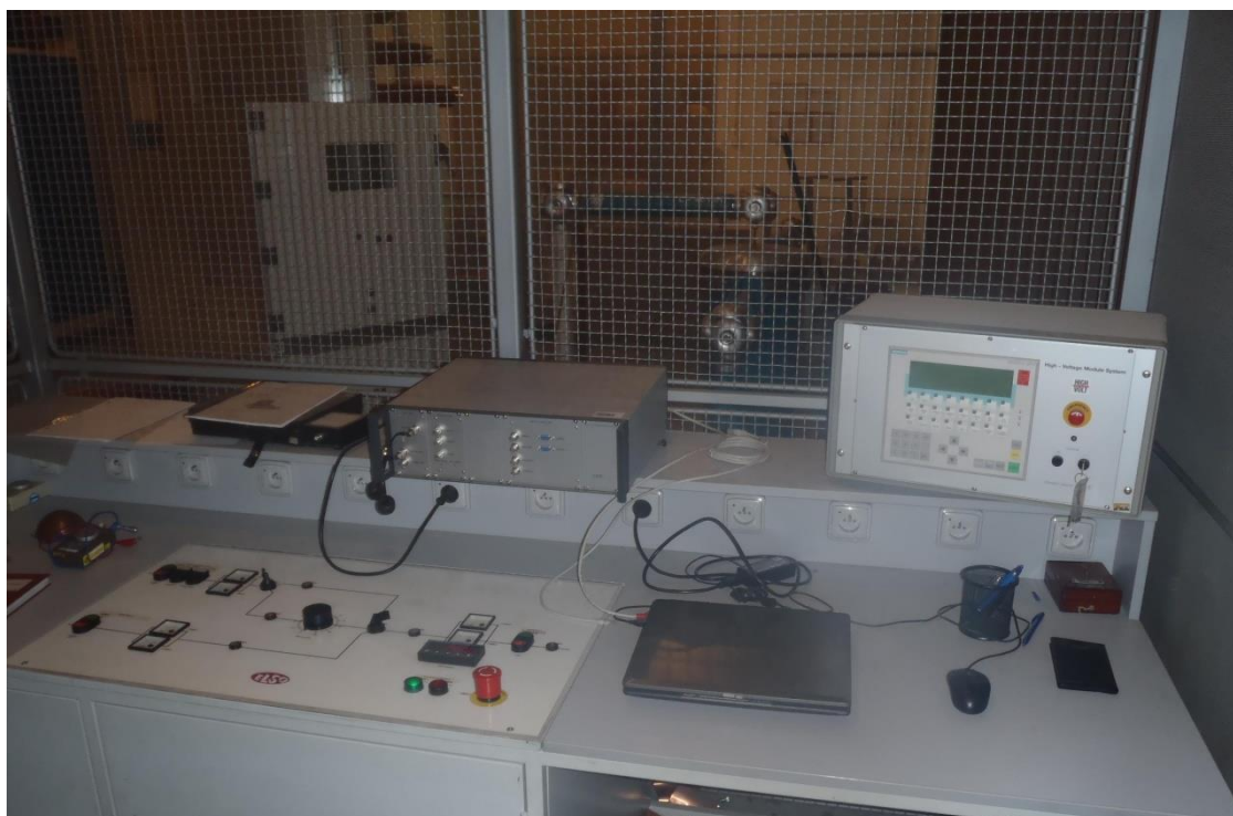
Obr. 14 Merací pult so zariadením LDS-6 v laboratóriu firmy ABB Brno
