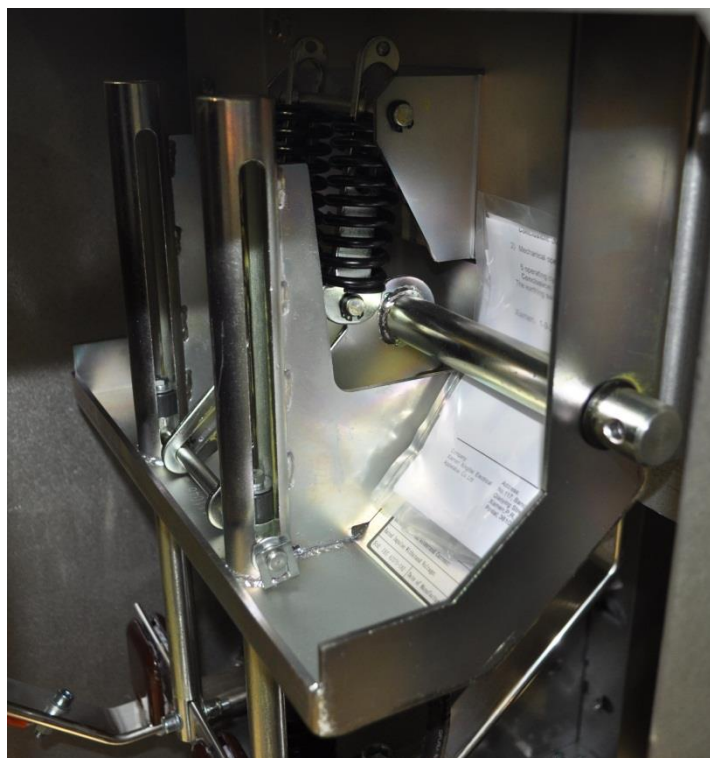
Obr. 11 Uzemňovač v rozvádzači ABB UniGear 550
