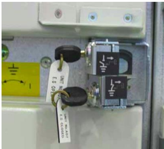
Obr. 12 Blokovanie pozície skratovača pomocou zámku v rozvádzači ABB UniGear 550
