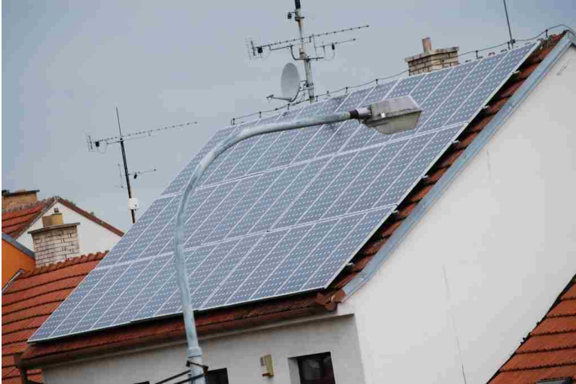
Obr. 6.2 Umístění fotovoltaické elektrárny na střeše rodinného domu
