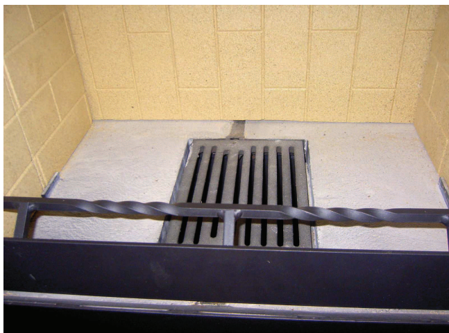
Obr.6: Pohled na spalovací komoru, rošt, hradítka
