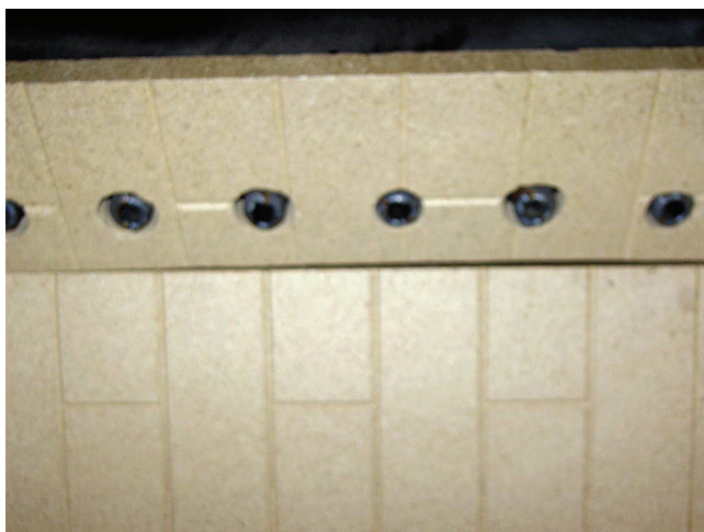
Obr.11: Přívod sekundárního vzduchu
