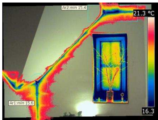
Obr. 22 Úniky tepla v podkrovním bytu [23]
