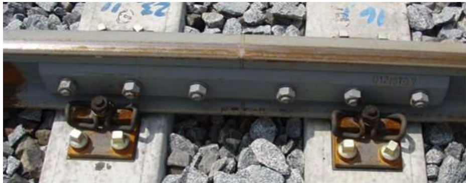
Obrázek 4: Lepený izolovaný styk na kolejnici ve výhybce (zdroj: www.szdc.cz )
