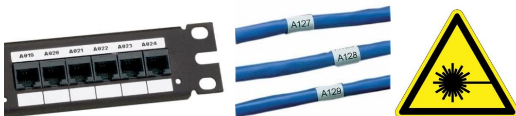
Obrázek č. 16: Popisky patch panelu, kabelu a výstražné značení (Zdroj: 16)
