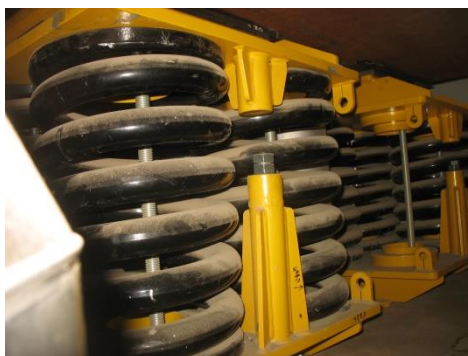
Obrázek 40 Pružiny pod kondenzátorem
