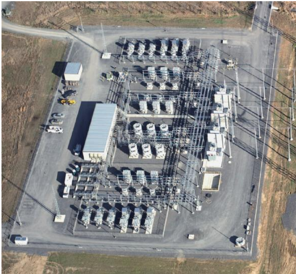
Obr. 5-18 Kompenzační SVC stanice Maryland[16]
