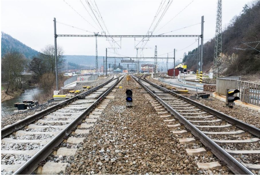
Obr. č. 16 – Pohled na výhybky 7 (vlevo) a 8 (vpravo) v žst. Ústí nad Orlicí
