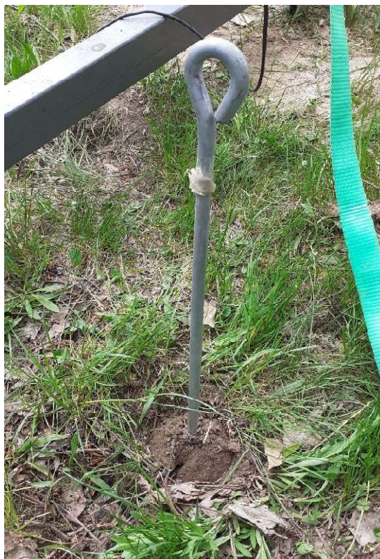
Obr. 9.4: Nezdařilá instalace kotvy č. 4
