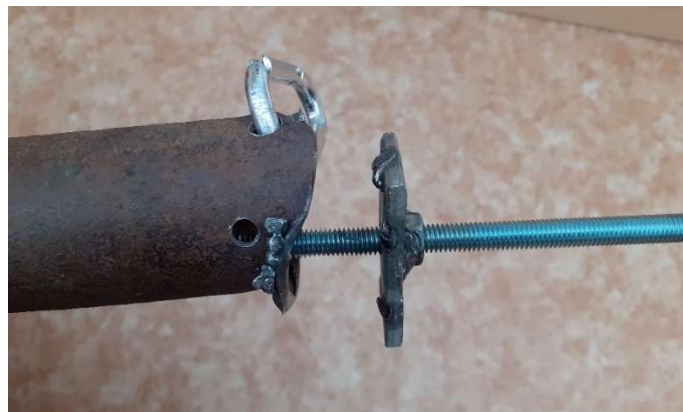
Obr. 9.1: Prasklé svary v horní části kotvy
