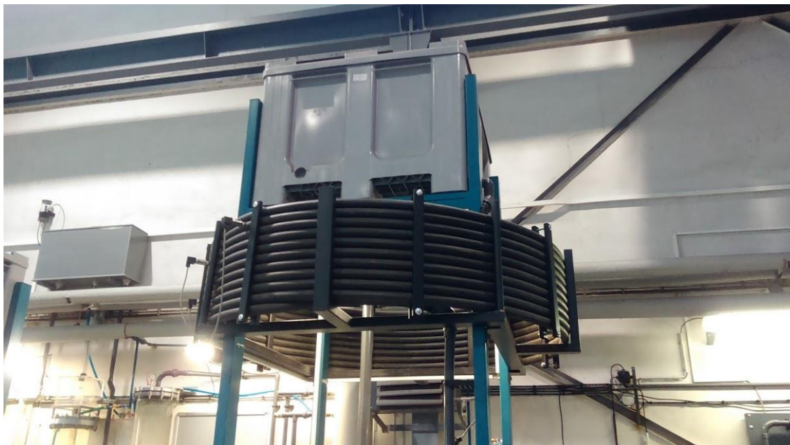
Obr. P-4 Horní nádrž s polyethylenovým potrubím
