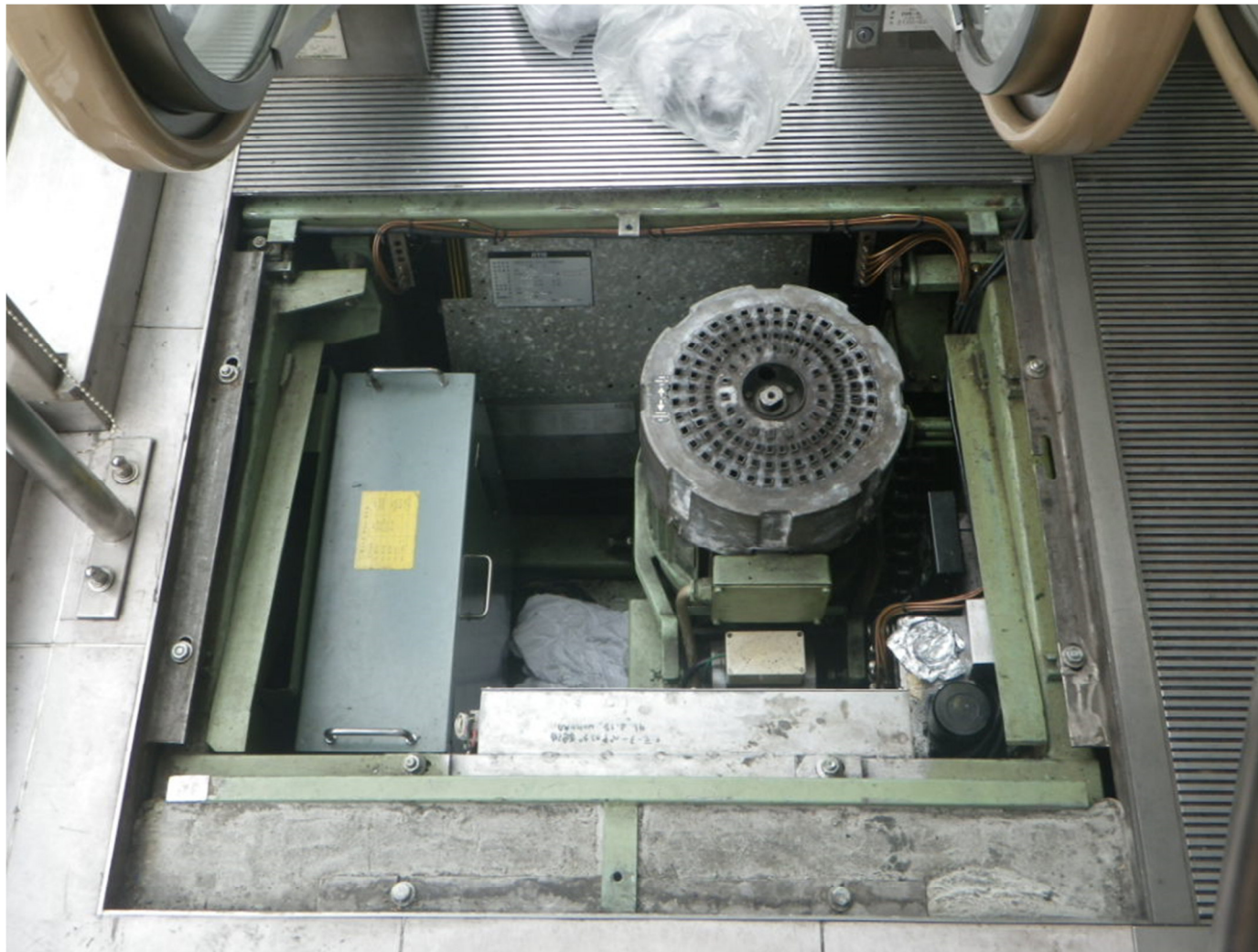
Obr. P11-2: Jednotky před modernizací, pohled do prostoru horní stanice.
