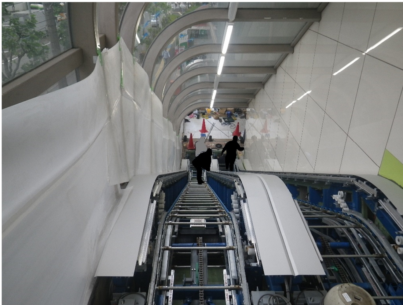
Obr. P11-5: Průběh modernizace, pohled ze shora na celý zdvih eskalátoru. Usazena část hliníkového krytí balustrády
