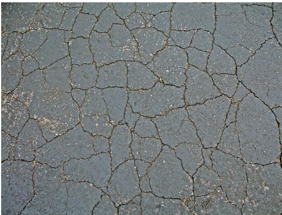
Obrázek 11 – Příklad poškození betonu vlivem alkalicko-křemičité reakce.
