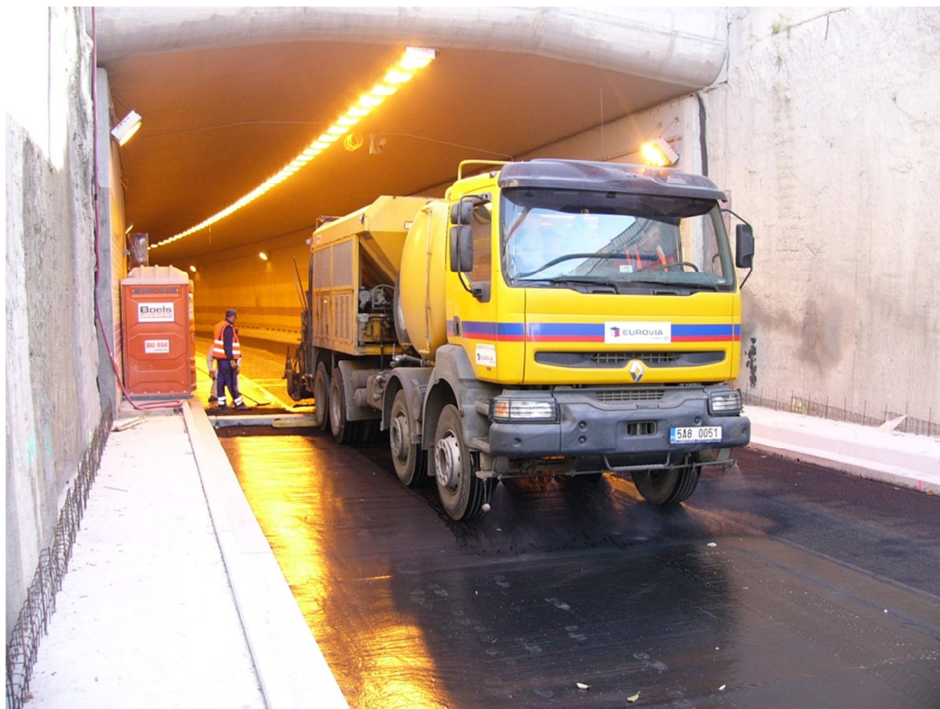
Obr. 2-24 Problémové místo - příčný odvodňovací žlab [38]
