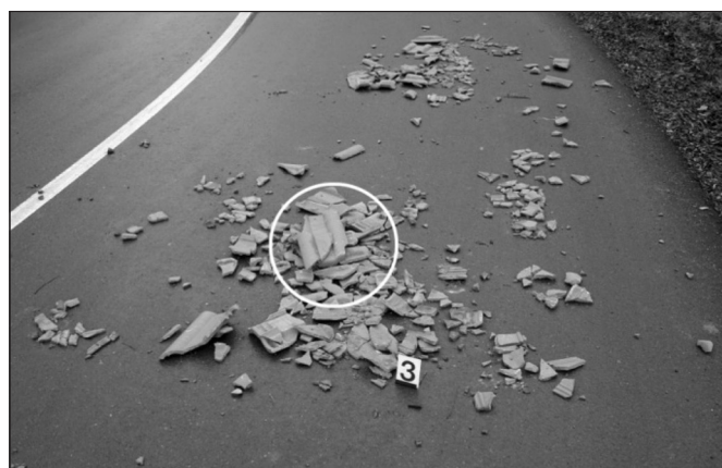
Obr. 20 Detail úlomků krytiny na silnici. Figure 20 Fragments detail of roofing on the road.
