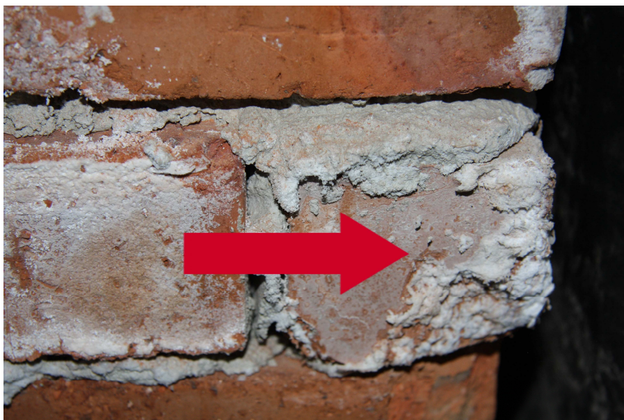
Obr. 2 : Výkvět solí ze stavebních materiálů
