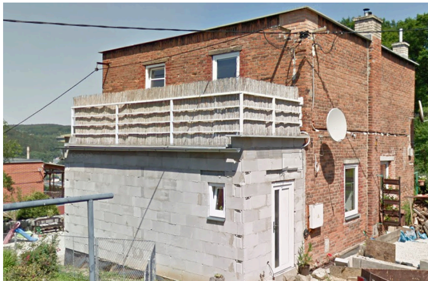
Obrázek 19 - Dům vypadající jako v průběhu rekonstrukce - ve skutečnosti je takto dlouhodobě udržován. Okna ani dveře neodpovídají předpisu. (zdroj: vlastní zpracování)
