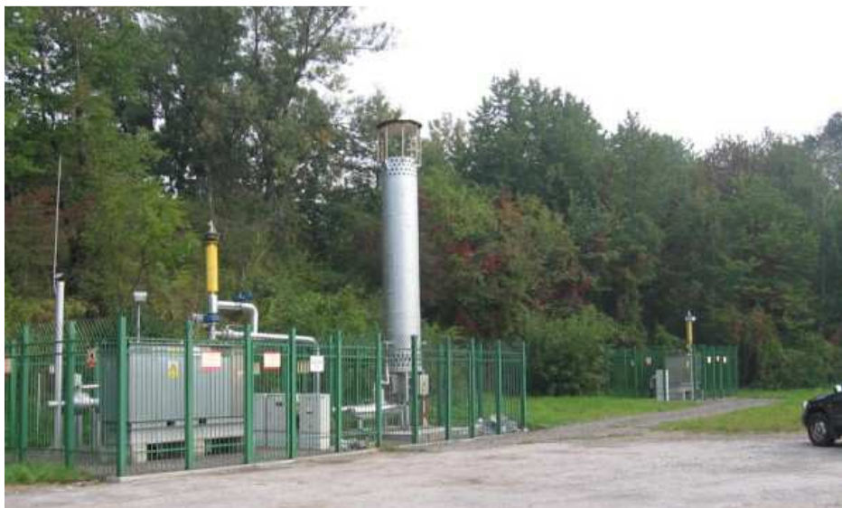
Obr. 15 Odsávací stanice důlního plynu [5]
