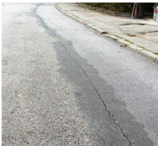
Obrázek č. 33 a 34 – Porucha netuhé vozovky dle TP 82 – Podélná trhлина. Zdroj: TP 82 159
