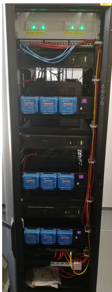
Obrázek č. 18 – UPS
